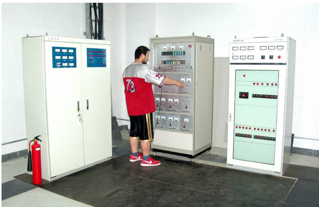
大功率电子辐照加速器示范工程-设备机房
