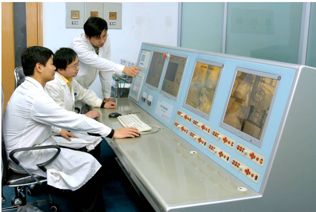
大功率电子辐照加速器示范工程-控制室
